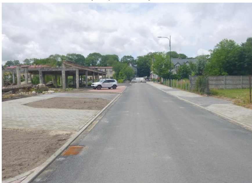
Fotografia 6 Budowa łączników między ul. Prof. J. W. Grotta a ul. 1-go Maja w Busku-Zdroju - po realizacji
